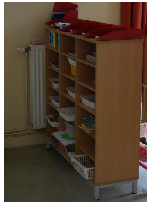
Radiateur obstrué par un meuble
