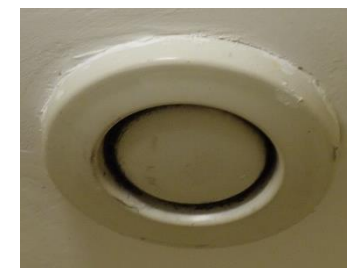
Bouches encrassées Débit : 0 m 3 /h lors de notre visite
