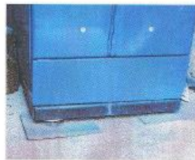
Supports antivibratiles placés sous une chaudière (doc. J.-L. Beaumier).
